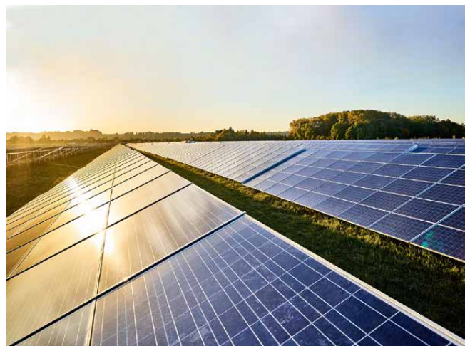
Solarpark von hep in Nordendorf. / Foto: hep
